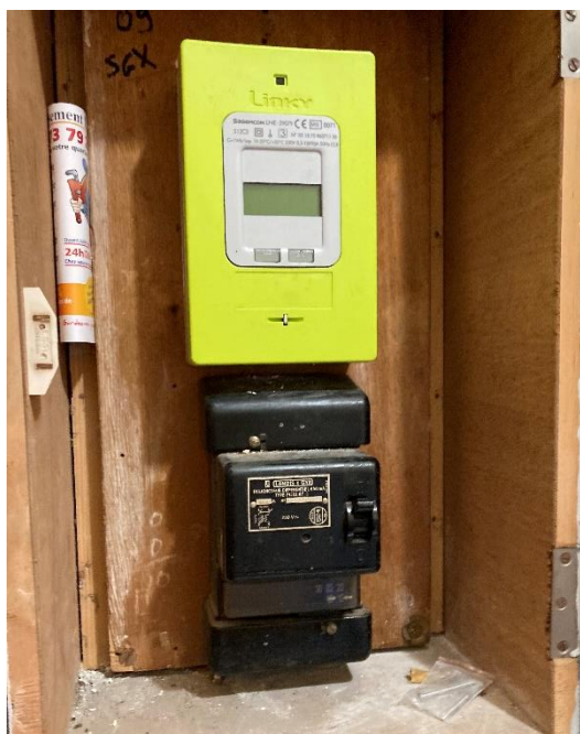
Compteur services généraux au RDC
