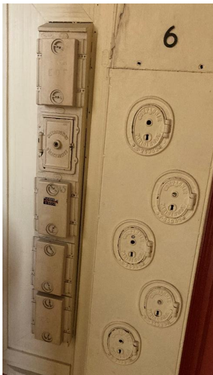
Colonne gaz et électricité – étage courant
