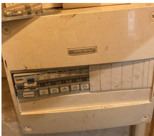
Logement 113 – différente génération sur l'installation
