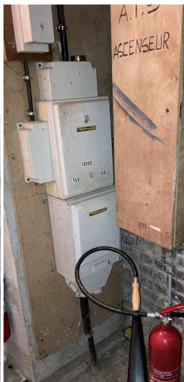
Arrivée électrique en caves
