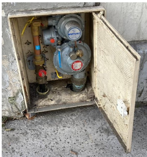
Arrivée gaz sur rue
