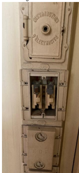
Palier type boîtier de raccordement "appartement" ouvert pour la visite
