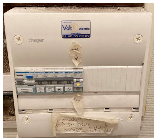
Logement 331 – différente génération sur l'installation
