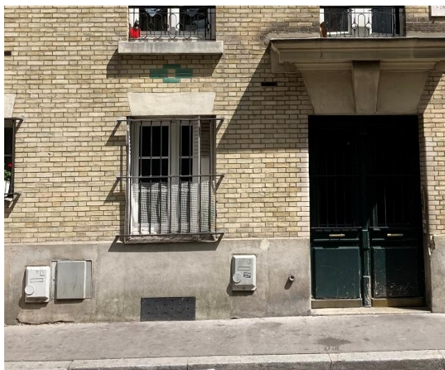
Coffret avec arrivée gaz sur rue
