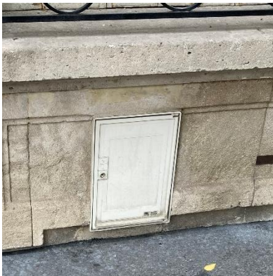
Arrivée gaz sous trottoir
