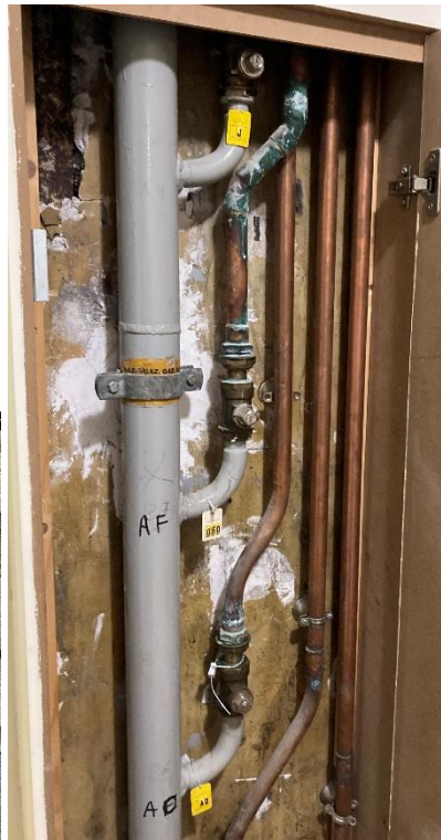
Colonne gaz – étage courant
