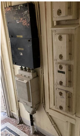
Départ de la colonne montante au rez-de-chaussée
